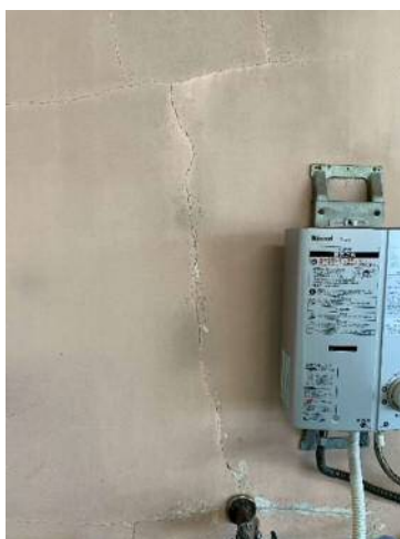
内装壁のひび割れ
