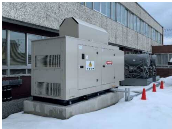
非常用発電機（市総合庁舎）
