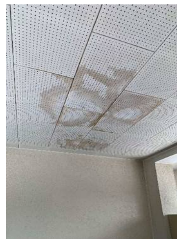
天井の雨漏り跡
