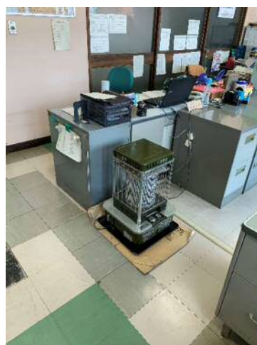
暖房機能の低下ため設置され たストーブ
