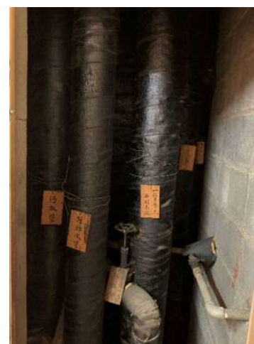
パイプシャフト空間が狭く 配管の取換えが困難な状況
