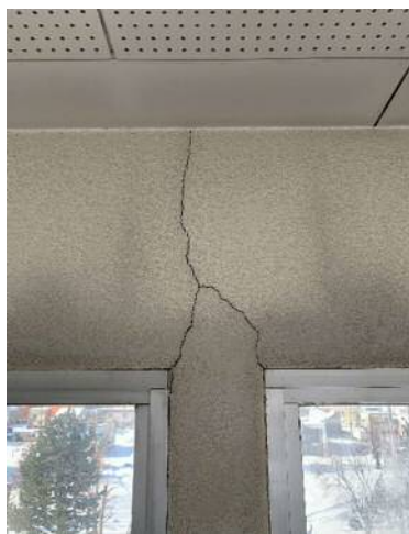
内装梁のひび割れ
