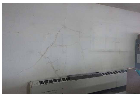
壁のクラック
