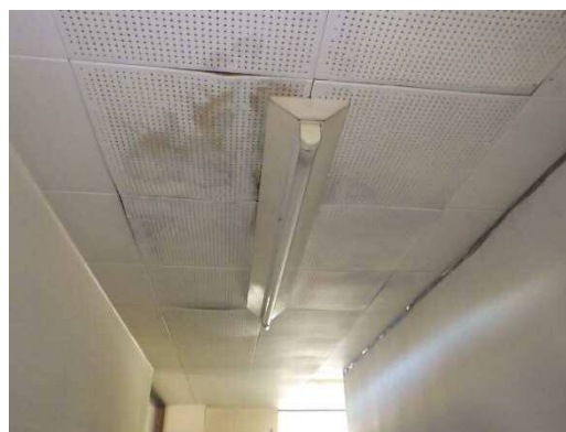
天井雨漏り跡
