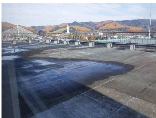
雨水が溜まる屋上防水
