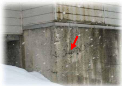
■コンクリートの剥離（外壁）■
