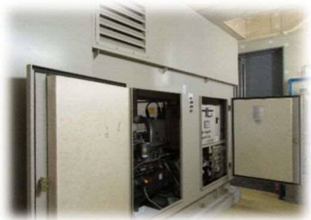
■自家発電設備（西芦別浄水場）■
