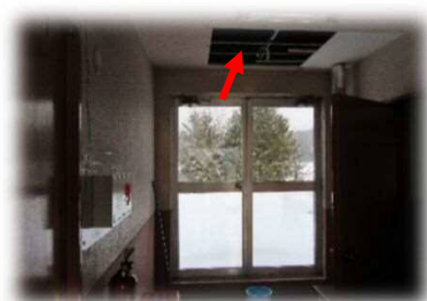
■天井からの雨漏り（管理棟）■
