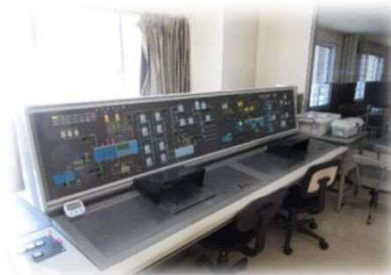
■中央監視操作盤（45年経過）■
