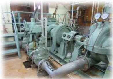
■No.2送水ポンプ（36年経過）■
