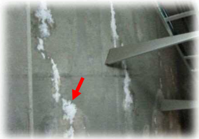
■コンクリートの遊離石灰（沈殿池）■
