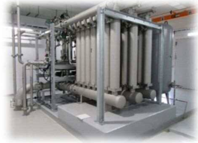
■参考 3,520m 3 /日級 膜ろ過施設■
