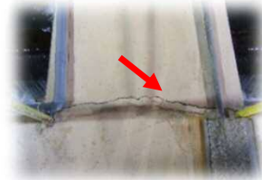
【コンクリートのひび割れ】
