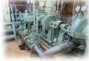
【No.2送水ポンプ(36年経過)】
