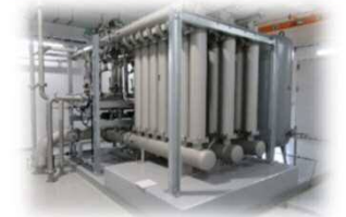
【参考 3520m 3 /日級 膜ろ過施設】
