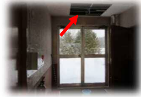
【天井からの雨漏り】
