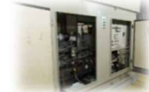
【参考 自家発電装置 (西芦別浄水場)】
