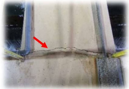
【コンクリートのひび割れ】
