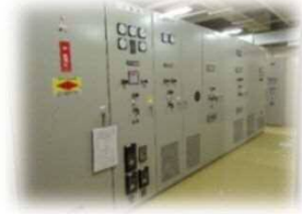
■ 西芦別浄水場（電気設備） ■
