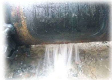
【送水管漏水（ダクタイル鋳鉄管）】
