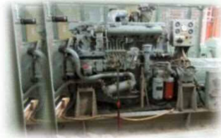
■ 芦別浄水場（送水ポンプエンジン） ■
