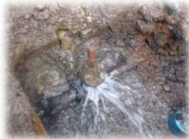
【配水管漏水（仕切弁）】
