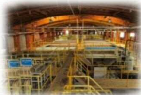
■ 芦別浄水場（浄水施設） ■
