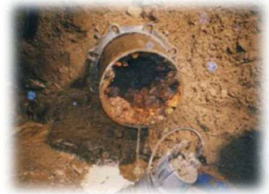
【配水管錆付着状況】
