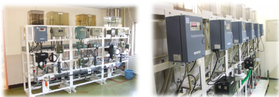
写真 1-3 芦別浄水場・西芦別浄水場水質測定計器
