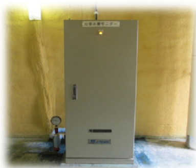
写真 1-1 水質監視モニター
