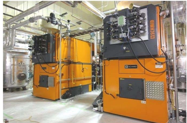
「木質チップボイラー」
