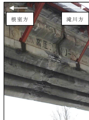
衝突箇所近景
