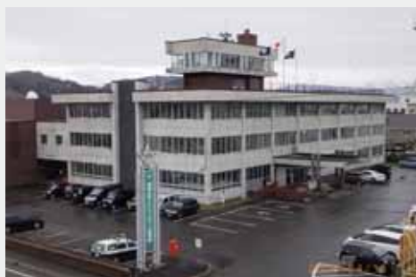
昭和44年に建設され、51年が経過した市総合庁舎。鉄筋コンクリート構造で減価償却耐用年数50年を経過。
